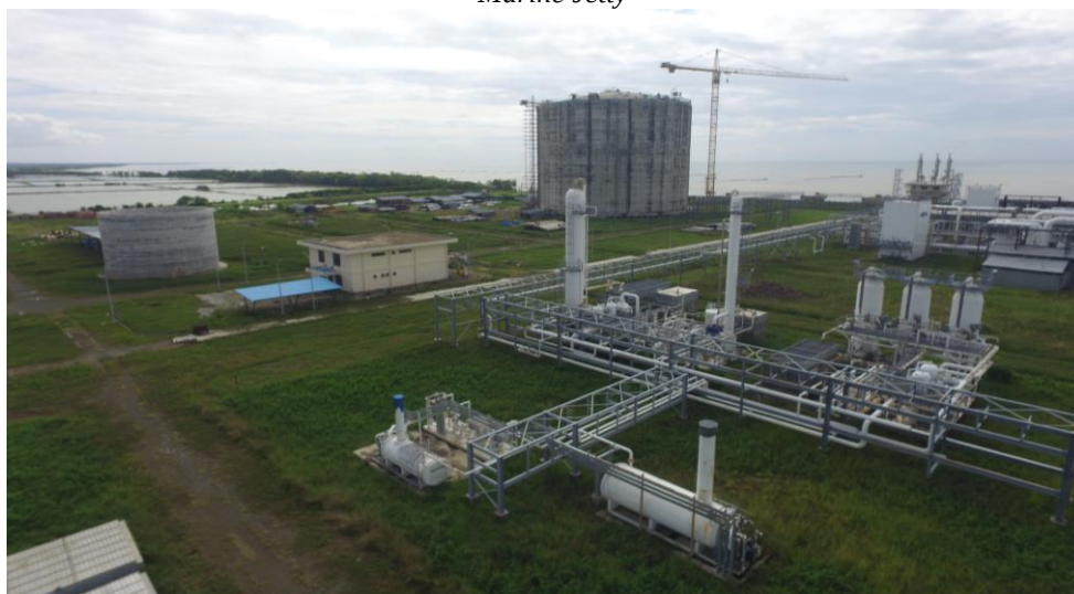
Sengkang LNG Plant
