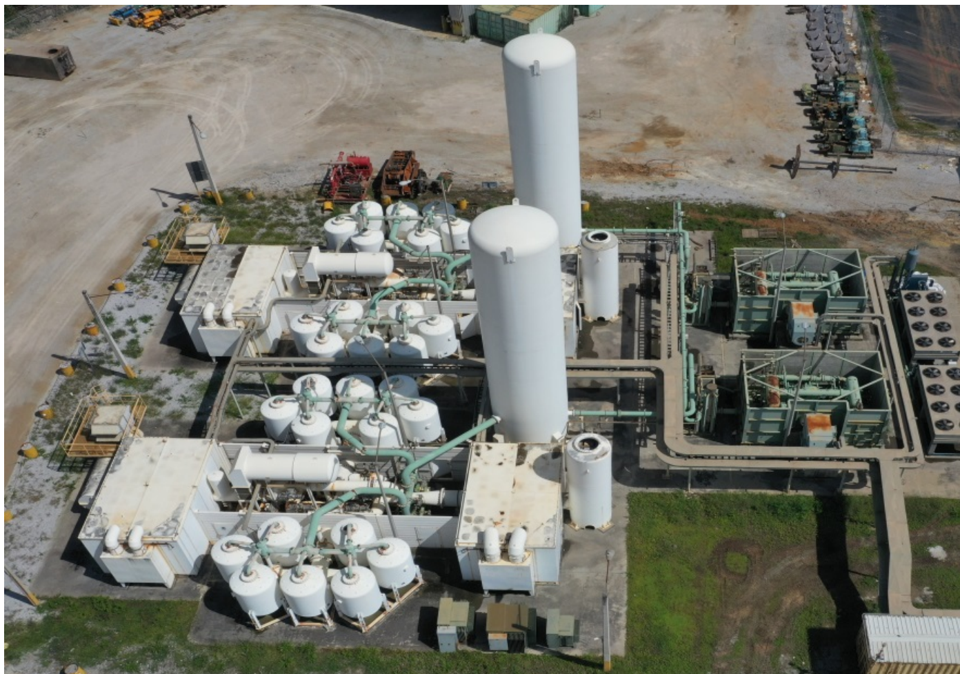
Las Lagunas Oxygen Plant
