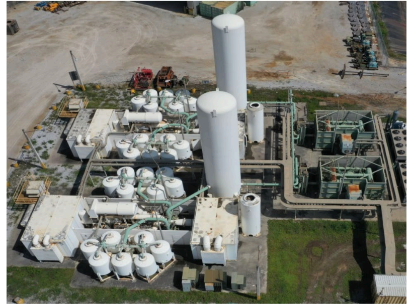
Las Lagunas Oxygen Plant
