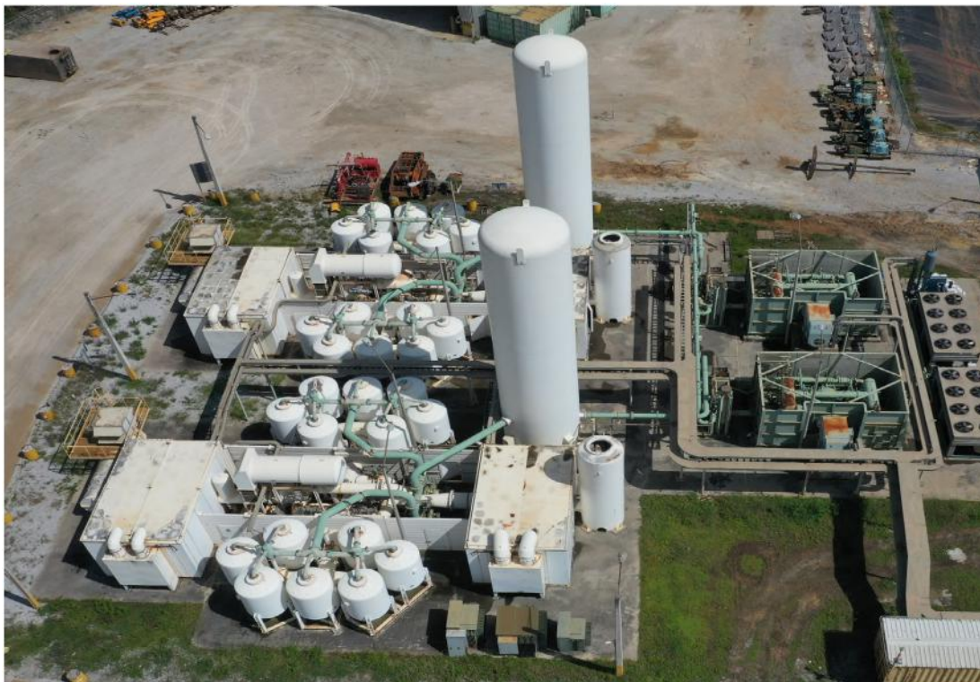
Las Lagunas Oxygen Plant
