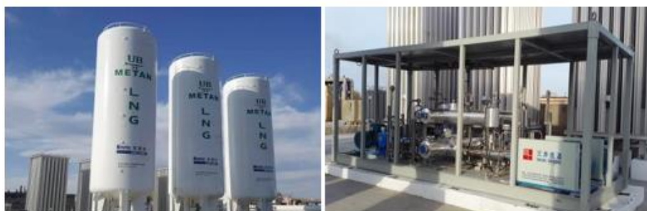
LNG Storage Tanks
