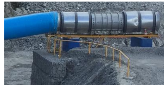
CC1400(2X150) kW VENT FAN
